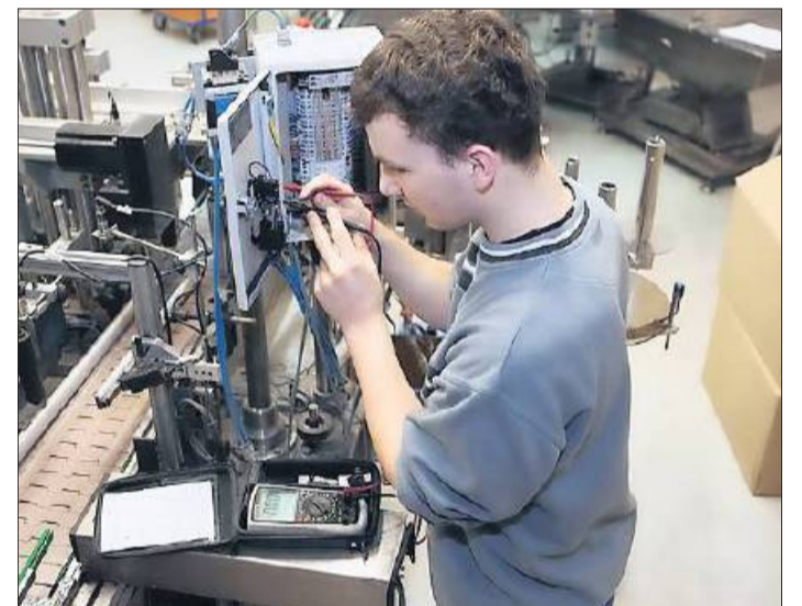
Die Stromdurchgängigkeit eines Schutzleiters wird gemessen.
